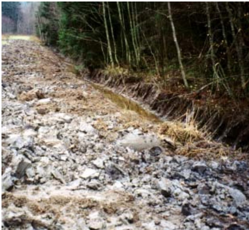
Figur 5. Slik skal det ikke gjøres: Stamnesbekken i Vestby er sterkt påvirket av jordbruksdrift og det ble foretatt en omlegging av elveløpet for en tid tilbake. All variasjon i elvekanalen ble tatt vekk, og meget viktige gyteplasser ble begravd under leire og silt.
