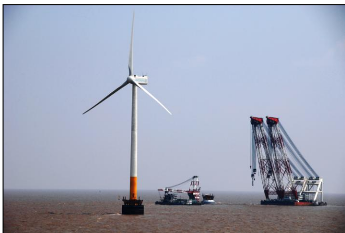
Bilde 11: Kinas første offshore vindmølle på 3MW ble installert utenfor Shanghai 1 april 2009. Det anslås at Kina har opptil 3 ganger så store vindressurser til havs (750GW) som på land og samtidig er energibehovet størst i storbyene langs kysten. Fremtiden ser lys ut for havvind i Kina.
